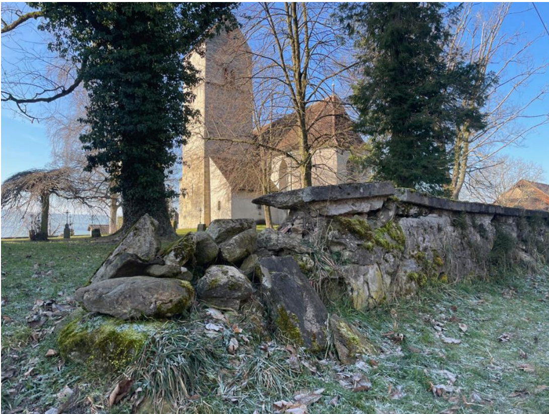
Die Schäden an der Ostseite der Mauer vor der Sanierung sind deutlich sichtbar
